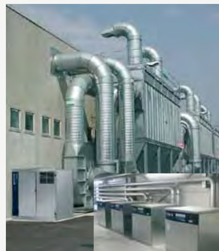
• промышленность: пневматическая транспортировка деревянных стружек вытяжной агрегат ROBOX evolution
